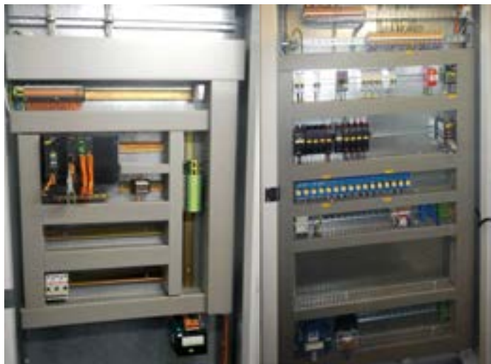
Bei der Realisierung des neuen Konzeptes für die Gebäudeautomation wurden die Schaltschränke ausgetauscht. Links: vorher. Rechts: nachher
